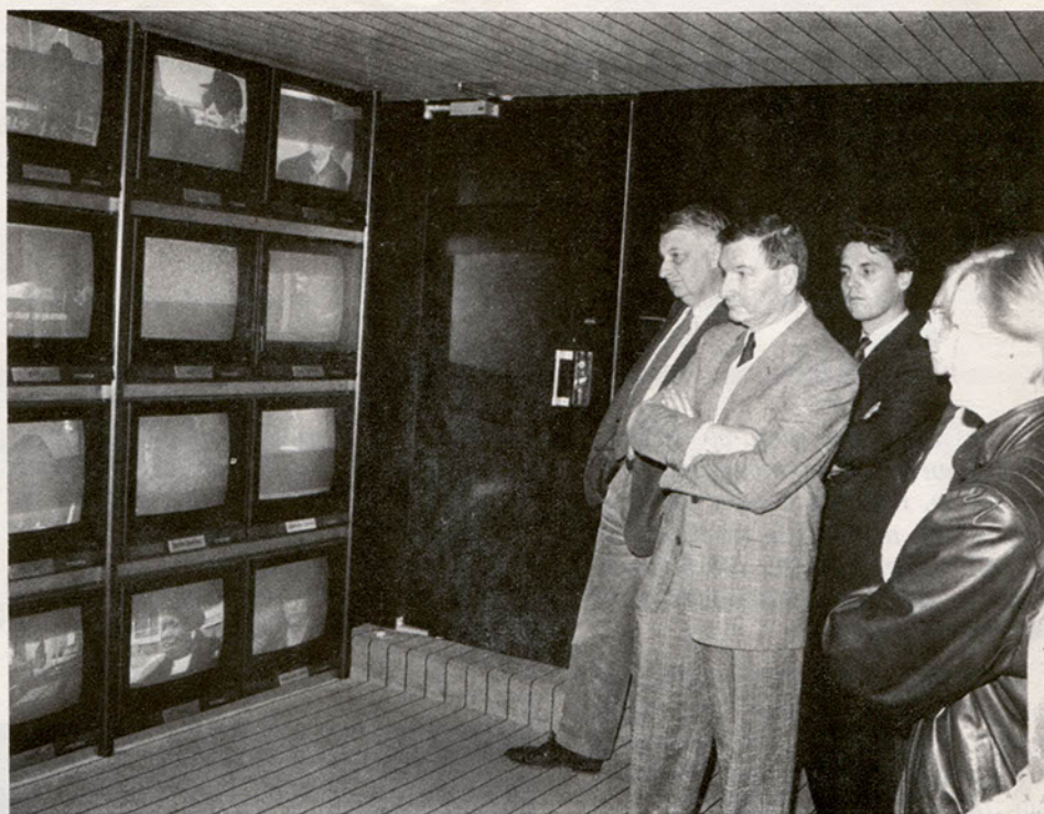
Les élus Croisiens devant le mur d'images du Centre de Télésurveillance de la Compagnie Générale de Chauffage.
